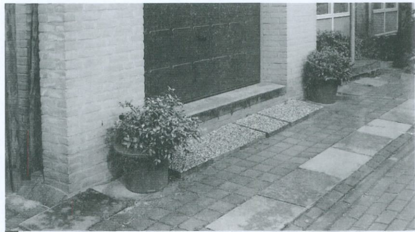
Figuur 3 De eigenaar van deze garage heeft moeite om zijn auto te stallen door de slappe bodem.
